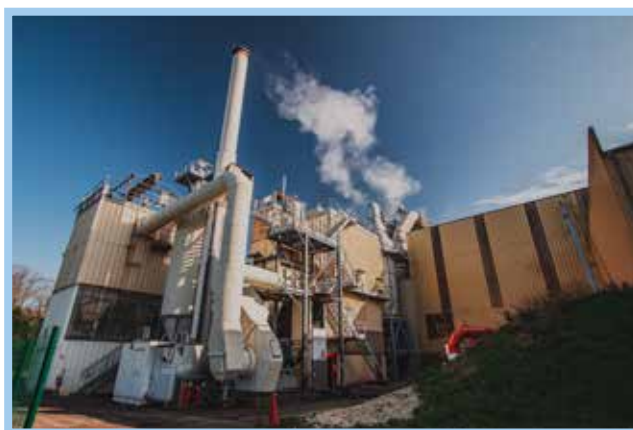
Une Unité de Valorisation Énergétique (UVE)
